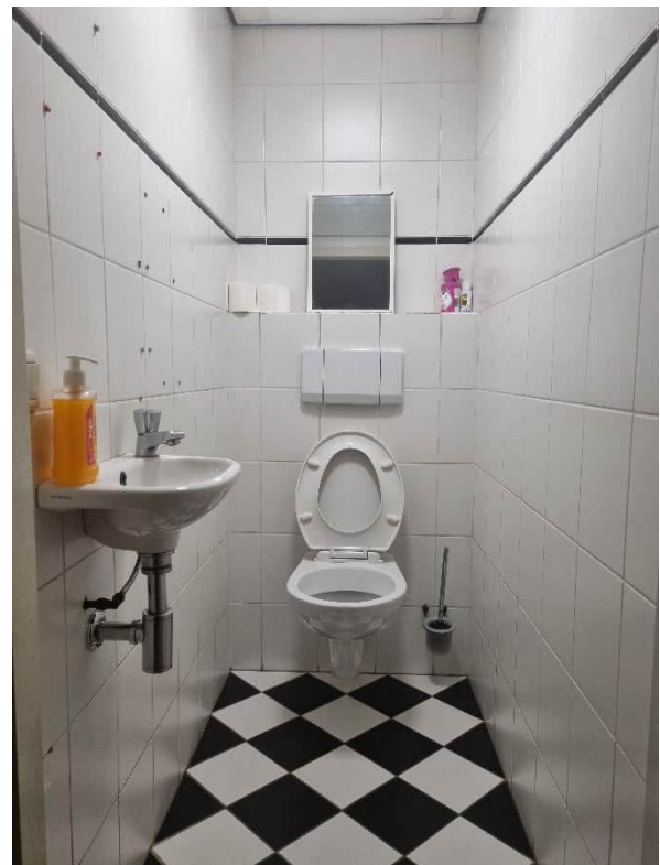
Toilet rechts, derde verdieping
